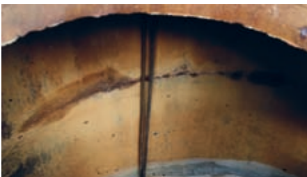
Feuchtigkeitseintritt zwischen Schachtringen
