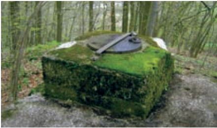
Bewuchs der Quellfassung
