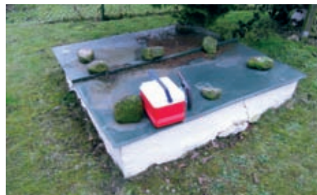
Undichte, mangelhafte Abdeckung
