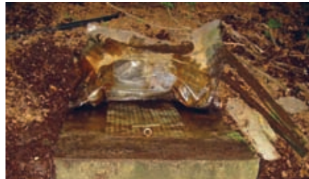
Quellfassung mit undichter Abdeckung und Gefahr des Übersürens (Hanglage)
