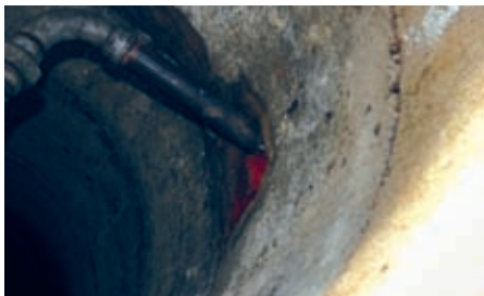
Nicht ausreichend abgedichtete Rohrdurchführung
