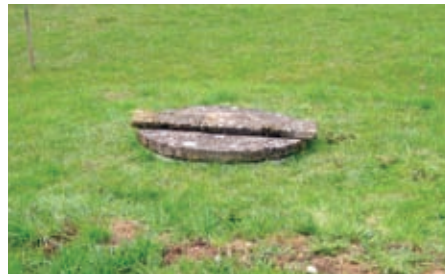
Betondeckel nicht tagwasserdicht
