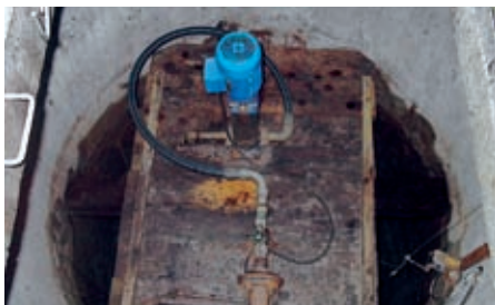
Stark verschmutzte, offene Holzabdeckung
