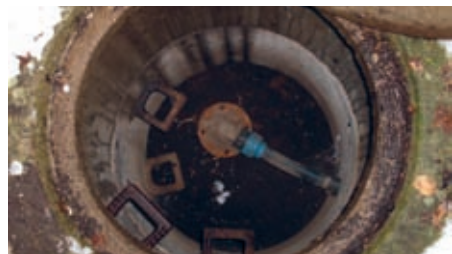
Wasser im Schacht, Wanddurchführung nicht dicht, Durchwurzelung Ringzwischenräume
